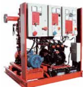
Gruppo di pompaggio
